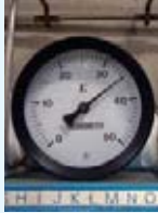
5 朝8時、早くも35度を示すボイラー室の温度計
