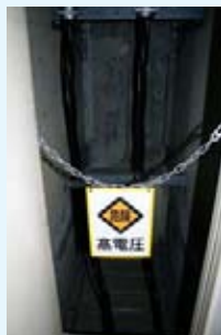
15 2万ボルトの特別高圧電線
