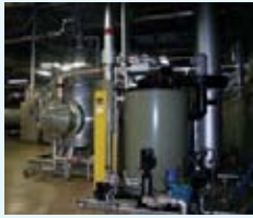
1 巨大な機械設備がうなりをあげて稼動する、平成館地下機械室
