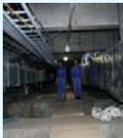
8 本館地下の空調ダクトと配管設備の見回りをする宮本利治さんと山木和寿さん
