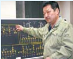
11 中央監視室のグラフィックパネルに目を光らせる坂井照良さん。ここにすべての情報が集約される
