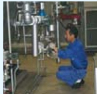
10 ボイラーのバルブを開めて、一日が終る
