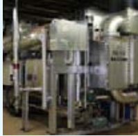
4 平成館の吸収式冷凍機。蒸気の熱エネルギーを使って、空調用の冷却水をつくる
