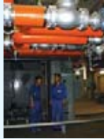
6 天井を蒸気管が縦横に走る本館機械室
