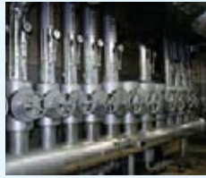
3 蒸気ヘッダー。ボイラーでつくられた蒸気はここから各館の機械に送られる。
