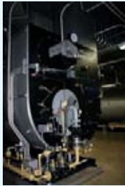
2 巨大なボイラー。夏も冬も、3台のうちの2台を稼働させる
