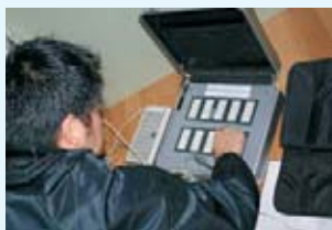
2. 平成館の照明調整板。
